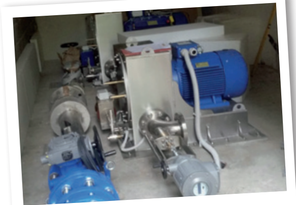
Wasserkraftwerk Druogno: Zentrale mit Turbine 884 m ü.M. mit zirka 100 kW Nominalleistung
