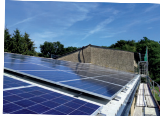
PV-Dachanlage Ranzig: Netzgang: Sept. 2017 / Leistung: 715,5 kWp
